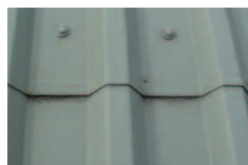
Dach mit Colorcoat HPS200® auf Galvalloy® Trägermaterial nach 7 Jahren.
